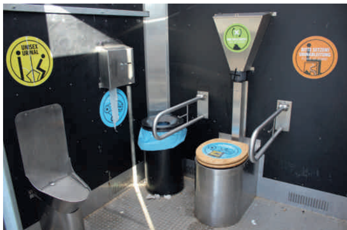
Trockentoilette im Lene-Voigt-Park.
