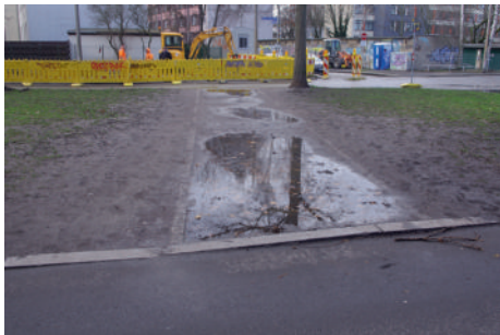
Noch unsanierte Querung der Gregor-Fuchs-Straße
