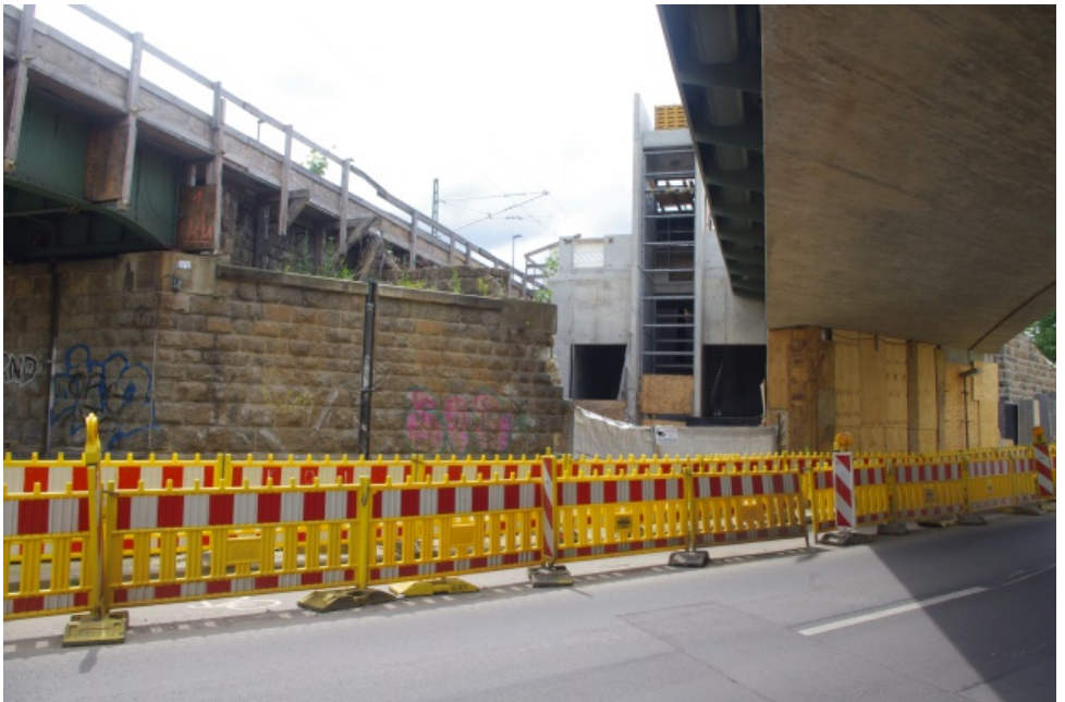
An der Zweinaundorfer Straße ist erst eine Brücke fertig gestellt (rechts). In der Bildmitte ist der Aufgang zum Mittelbahnsteig mit Fahrstuhlschacht schon zu erahnen. Der Bahnverkehr rollt derzeit noch über die alte Brücke (links), die noch abgebrochen und bis 2024 ersetzt wird.
