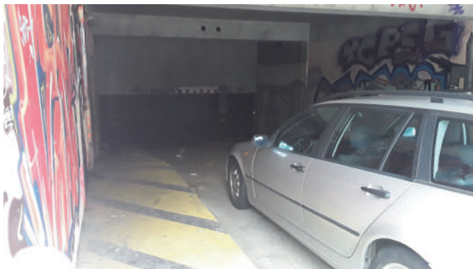
Parkhaus Gemeindeamtsstraße in Lindenau. Seit Jahren ungenutzt und geschlossen. Dreck, Graffiti, Vandalismus.
